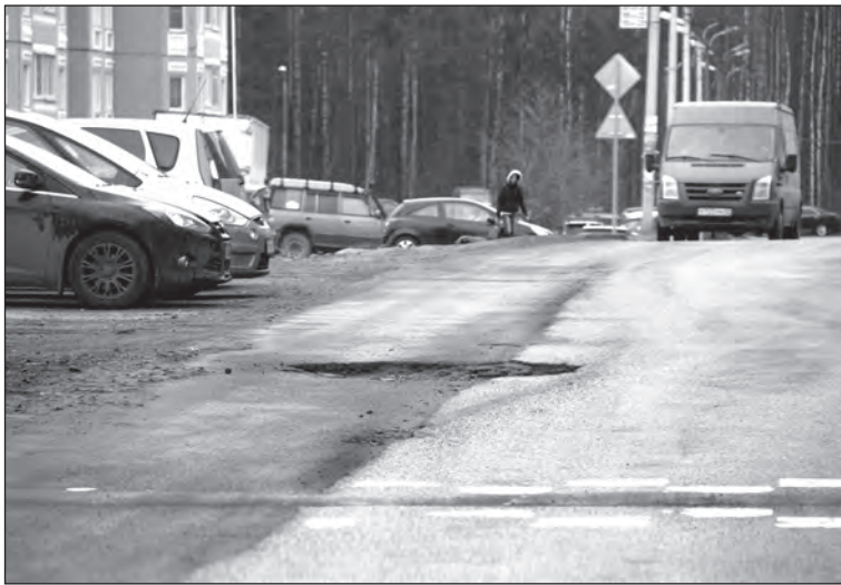
ул. Молодцова; Молодцова – в районе д. 3 по ул. Молодцова. ремонт проезда к дворовой территории д. 9 и д. 3 по ул. Молодцова. Наш корп.
